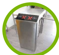
Control de acceso peatonal
